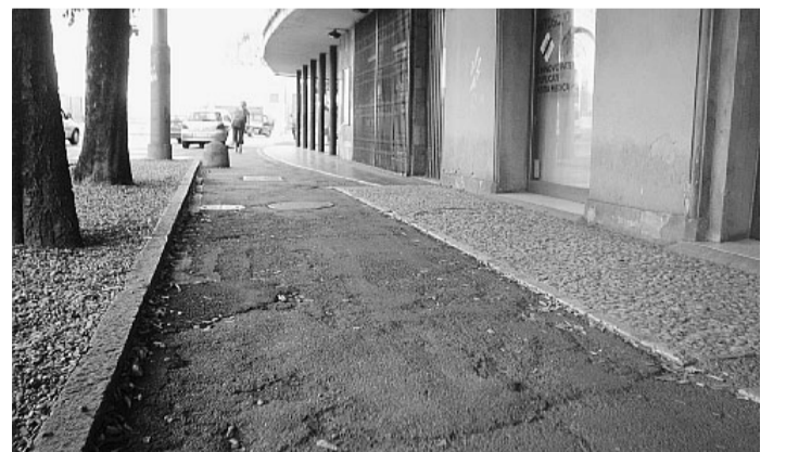
Asfalto dissestato nella ciclabile di fronte all'ex cinema Principe
